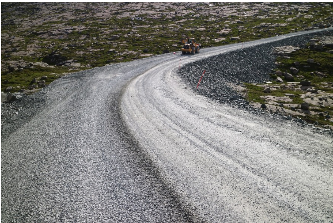
Guleslettene vindkraftverk i Kinn kommune juli 2019: Merk den mørke stripen i veien frem til maskinen. Her har det oppstått en oljelekkasje på en stor maskin (en shovel) inne på fjellet. Foto: Sveinulf Vågene
